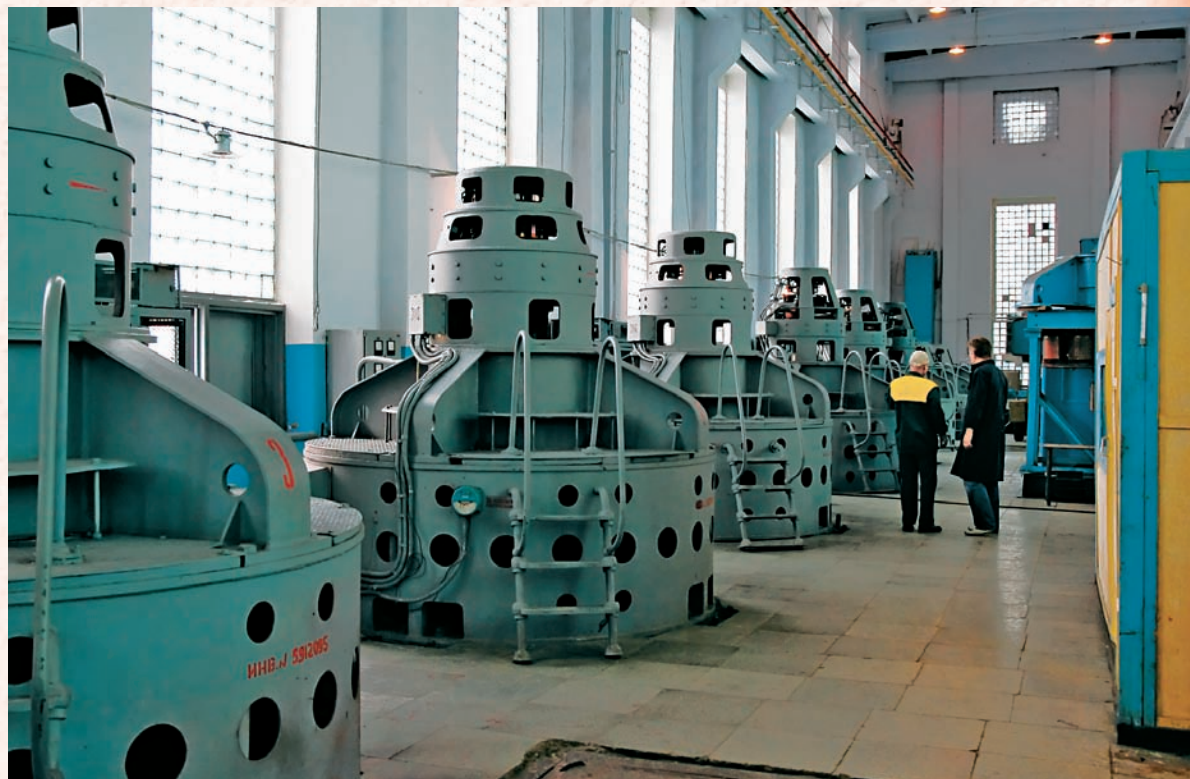
Насосная станция № 1, машинный зал. 2006 г.
