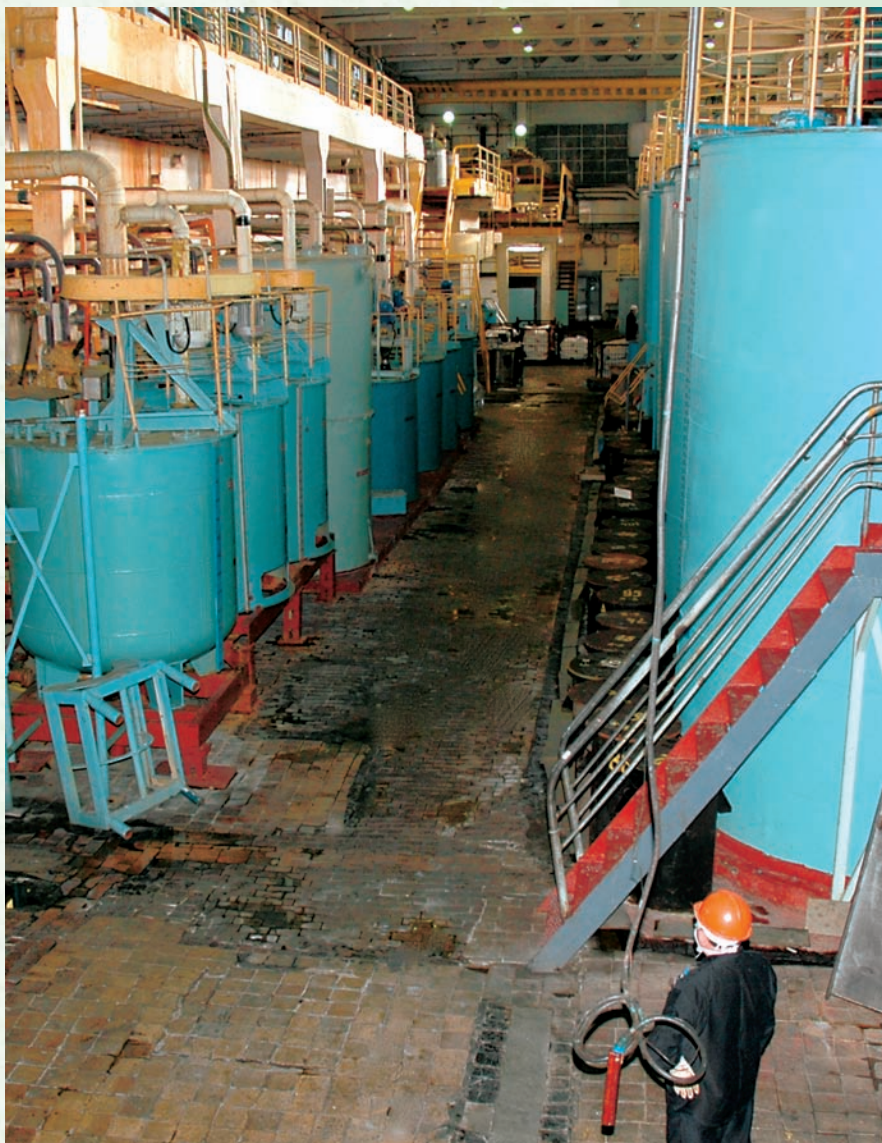
Производственное оборудование участка по переработке отходов, х/ц 3
