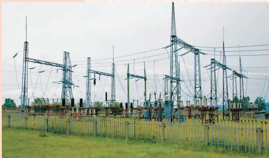
Подстанция береговой насосной станции № 1. 2006 г.
