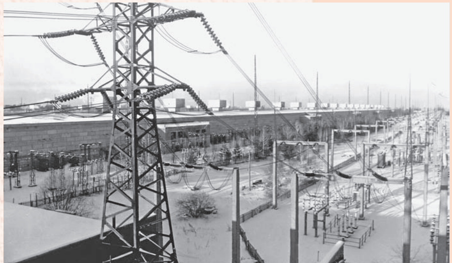
Питающая подстанция (газодиффузионный завод). 1989 г.
