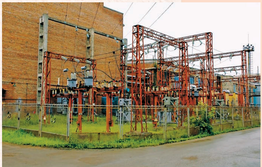
Подстанция фторного производства сублиматного завода. 2006 г.
